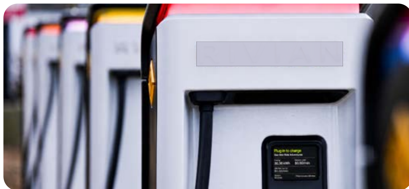
EV 充電スタンド
